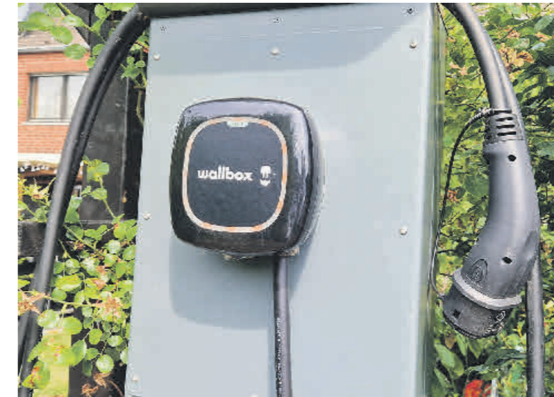
Die Wallbox als Sinnbild für die Elektromobilität: Stand jetzt sind E-Fahrzeuge in der gesamten Ökobilanz erst nach gewissen Kilometerleistungen den Verbrennern überlegen. Foto: Peter Kellerhoff
